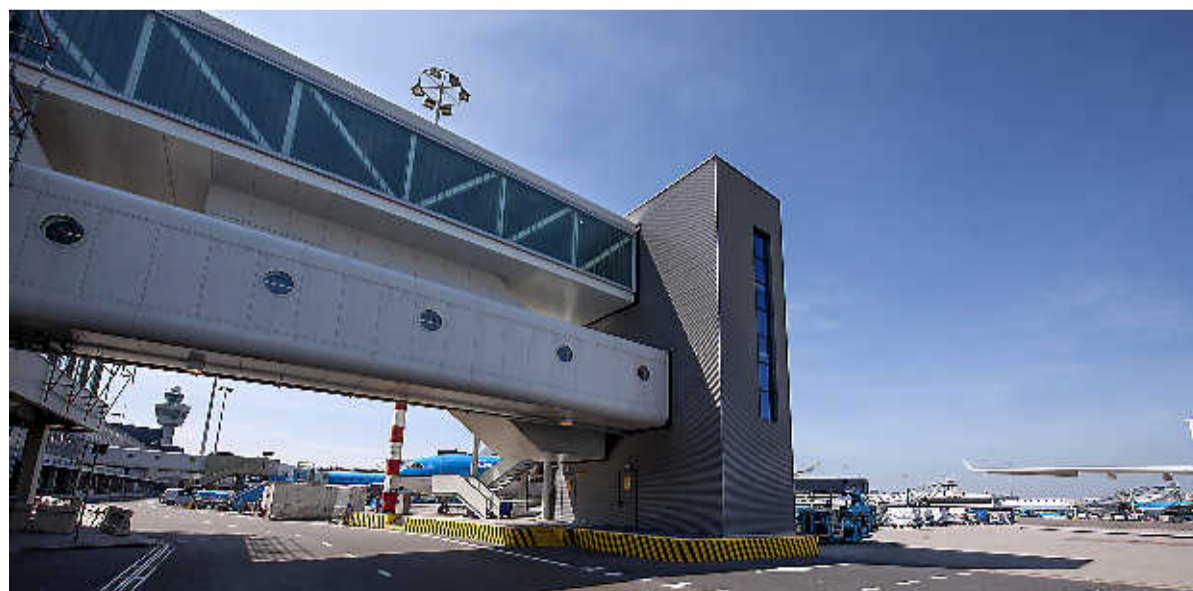
Een van de vele klussen, de loopbruggen of vliegtuigslurven op Schiphol zijn van een nieuwe 'jas' voorzien. FOTO TOES
